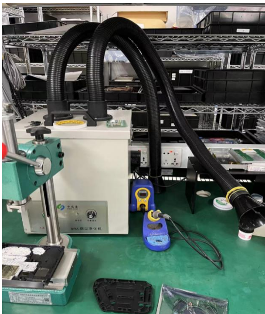
废气处理设施
